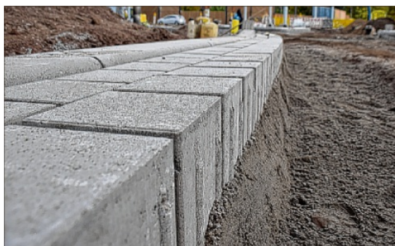
Hier ist noch klassische Handarbeit gefragt: Die Pflastersteine als Abschluss müssen sauber verlegt werden.
